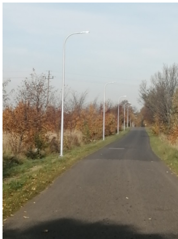
Nowe oświetlenie uliczne w miejscowości Kaszewice
