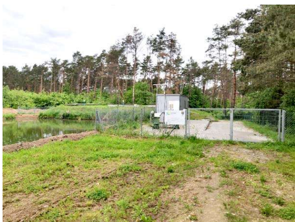
Oczyszczalnia ścieków na Osiedlu Leśnym w Klukach
