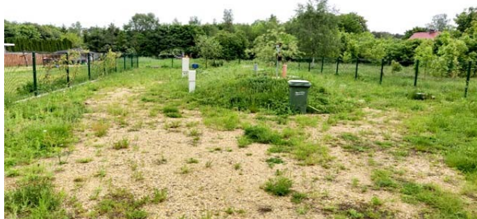
Oczyszczalnia ścieków przy blokach wspólnoty mieszkaniowej w Klukach
